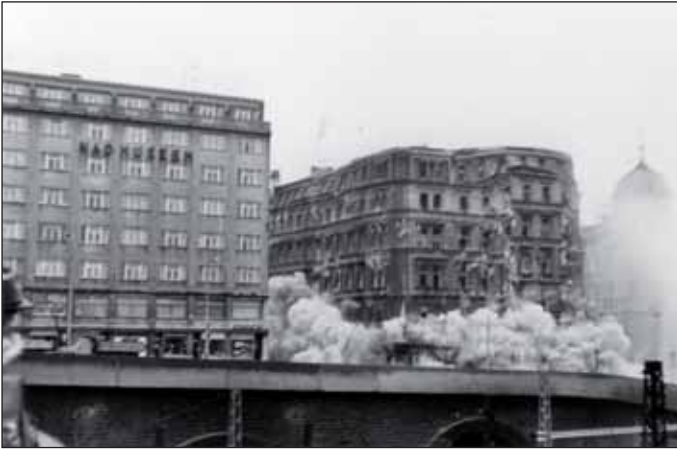
Obr. 2 Demolice domu ve Vinohradské ulici při výstavbě Severojižní magistrály Fig. 2 Demolition of a building in Vinohradská Street during the construction of the North-South Trunk Road
