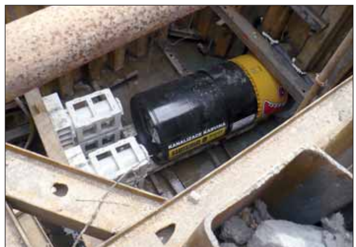
Obr. 4 SO 04 Ražba kanalizačního sběrače „C“ pomocí ISEKI DN 1400 (foto Ing. Petr Szotkowski)
