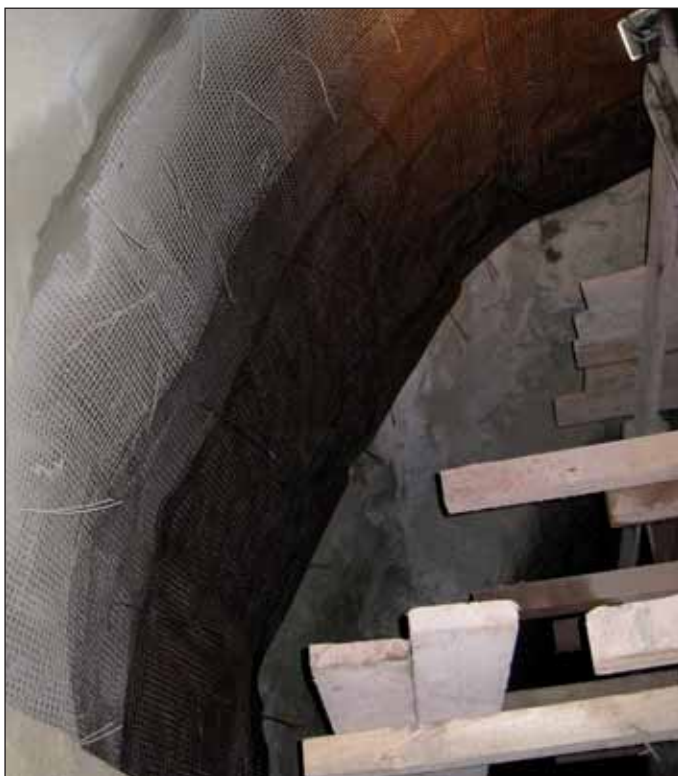
Obr. 10 Banskoštiavnický tunel – hydroizolační nopová fólie Fig. 10 Banská Štiavnica tunnel – dimpled waterproofing membrane
