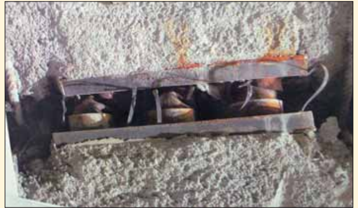
Obr. 4 Stlačené deformační prvky Fig. 4 Compressed yielding elements
