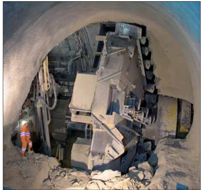
Obr. 7 Řezná hlava stroje TBE míjí propojku pro pěší Fig. 7 TBE-cutterhead passing an accessible cross-passage
