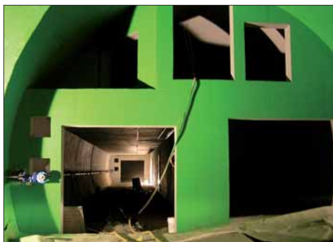
Obr. 6 Propojka č. 5 a výdechová část vzduchotechnického objektu Nouzov (st. 513) Fig. 6 Cross passage 5 and exhaust part of the Nouzov ventilation station (lot 513)
