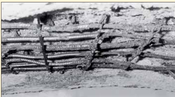
Obr. 3 Detail obnažené výztuže způsobené odstřelením betonu Fig. 3 Detail of reinforcement exposed due to concrete spaling
