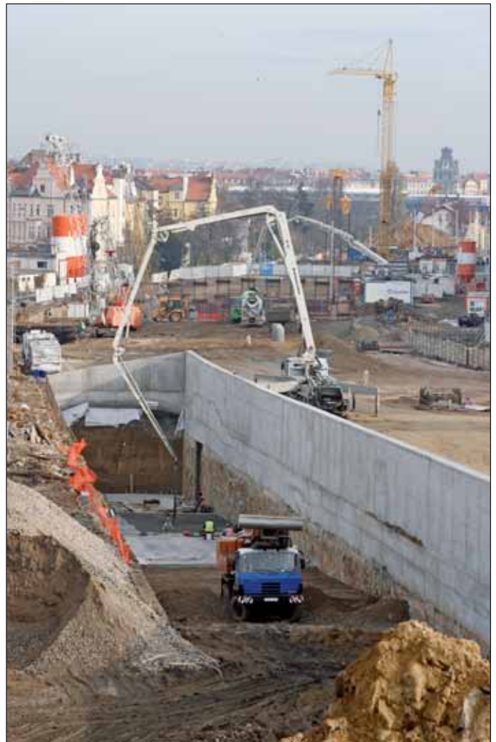
Obr. 5 Staveniště Hradčanská, dokončené dilatace stropu tunelu a betonáž dna rampy 1 Fig. 5 Hradčanská construction site: complete expansion blocks of the tunnel roof deck, casting of the bottom of Ramp 1
