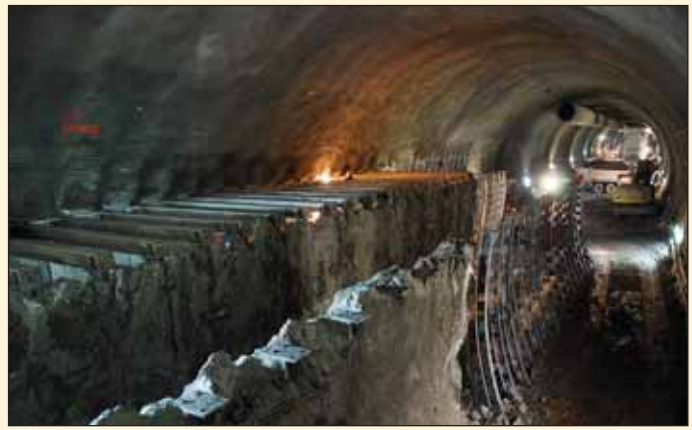
Obr. 4 Ražba tunelu – přechod na plný tunelový profil (Foto: Pechman) Fig. 4 Tunnel excavation – Transition to a full tunnel profile (Photo courtesy of Pechman)
