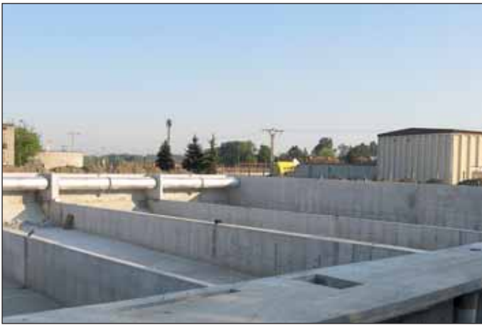
Obr. 3 SO 03 Dešťová zdrž DZ č. 2 (foto Ing. Adam Lubojacký) Fig. 3 SO 03 The stormwater retention basin, SRB 2 (Photo courtesy of Ing. Adam Lubojacký)
