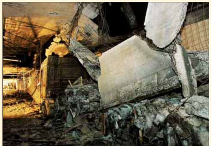
Obr. 2 Destrukce tunelového ostění po požáru Fig. 2 Tunnel lining destruction after a fire
